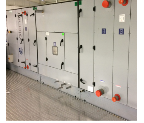
Kabin üzerine yerleştirilmiş unite AMU Unit placed on top of the booth
