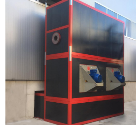
Fabrika dışına yerleştirilmiş unite AMU Unit placed on outer factory walls
