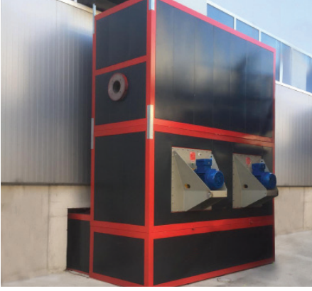
Fabrika dışına yerleştirilmiş unite AMU Unit placed on outer factory walls
